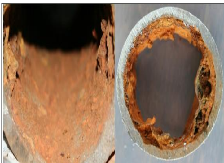
شکل ۳- لایه زیستی در لوله انتقال آب
